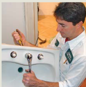
ED CUNHA Plumbing
