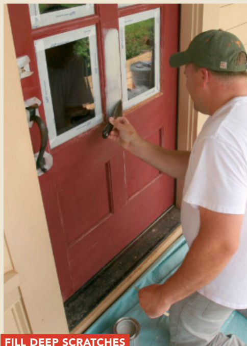
FILL DEEP SCRATCHES
