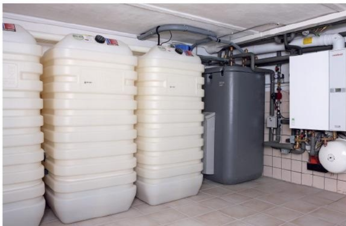
Modernisiertes, platzsparendes Öl-Heizungssystem im Heizraum mit wandhängendem Brennwertgerät von Hersteller Weishaupt, neuer Warmwasserspeicher und geruchsdichte Tanks. IWO
