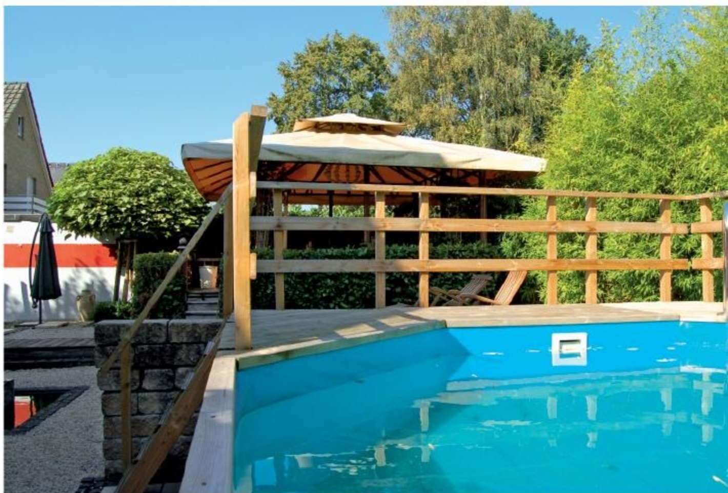
Heiztechnisches Sahnehäubchen: Neben der Erwärmung des Hauses übernimmt die Gesamtanlage auch die Aufgabe, das Schwimmbadwasser auf Temperatur zu bringen.
