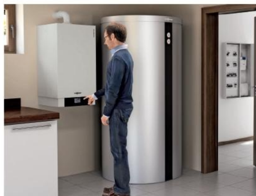
Um die Laufzeit zu verlängern, werden Mikro-KWK-Anlagen mit Pufferspeichern kombiniert. Neben dem Wandgerät „Vitolwin 300-W“ steht hier zum Beispiel ein 750-Liter-Speicher. Viessmann
