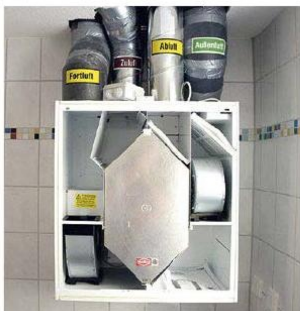
Blick in ein kompaktes zentrales Zu- und Abluftgerät mit Luftleitungsanschlüssen: Die Wärmerückgewinnung ist in der Mitte, die Ventilatoren sitzen links unten und rechts oben. www.heliosventilatoren.de
