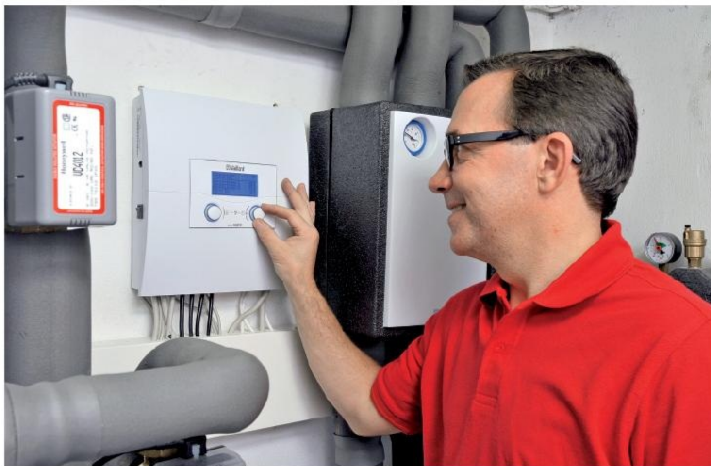
Alle Heizsystem-Komponenten nutzen den „eBus“ zur Kommunikation. Eine zentrale Regelung steuert die gesamte Anlage auf der Basis objektspezifisch eingestellter Parameter.
