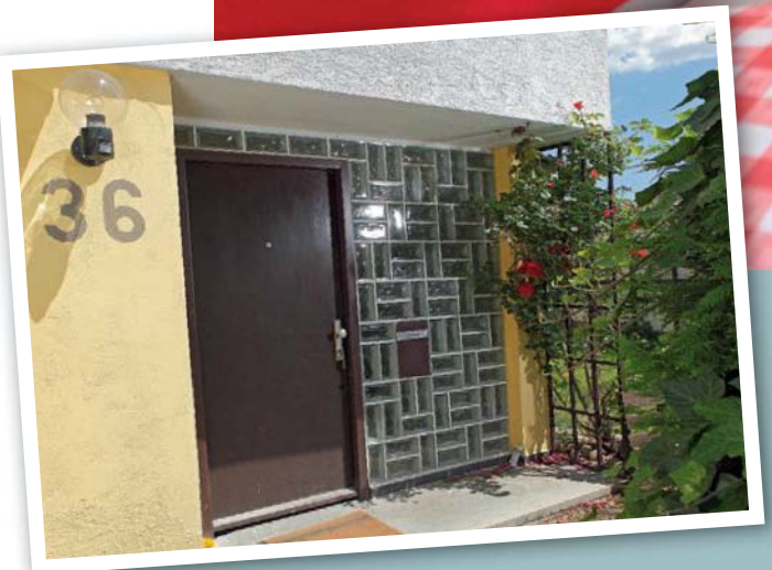
Glassteinwand, braune Holztür, Energieverluste und wenig Komfort. Nicht nur außen war dringend Renovierung angesagt. Auch der Eingangsbereich dahinter war alles andere als einladend.
