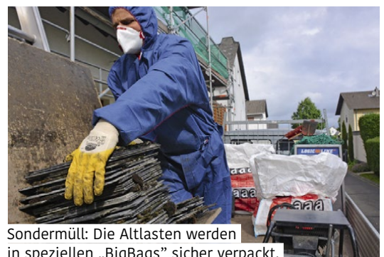
Der Dachdecker fand die Asbestplatten in einem absolut desolaten Zustand vor.
