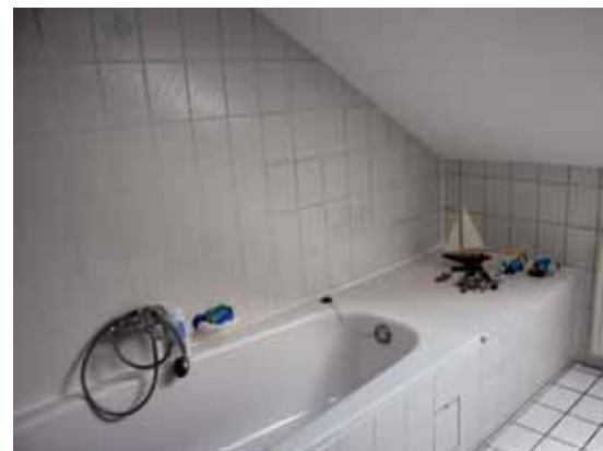
Das Motiv auf den Fliesen ist nicht mehr modern, die Fugen sind ungleichmäßig gedunkelt und verschmutzt. Deshalb gleich neu fliesen?
