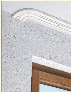
1 Deckenmontage: Eine auf Putz montierte 3-läufige Vorhangschiene mit runder Retoure.
