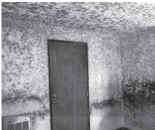
Mold fills a basement.
