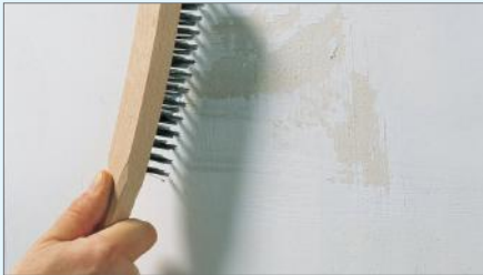
5 Maroder und stark sandender Putz wird mit einer Drahtbürste bearbeitet.
