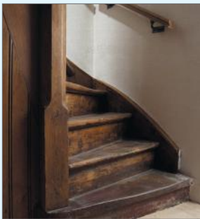
1 Einige der ramponierten Trittstufen.
