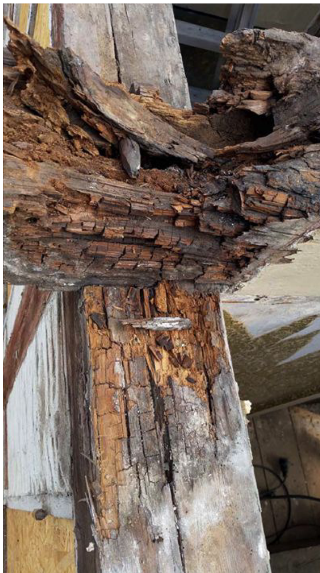
Im Gebälk und im Mauerwerk hatte sich der Echte Hausschwamm breitgemacht.
