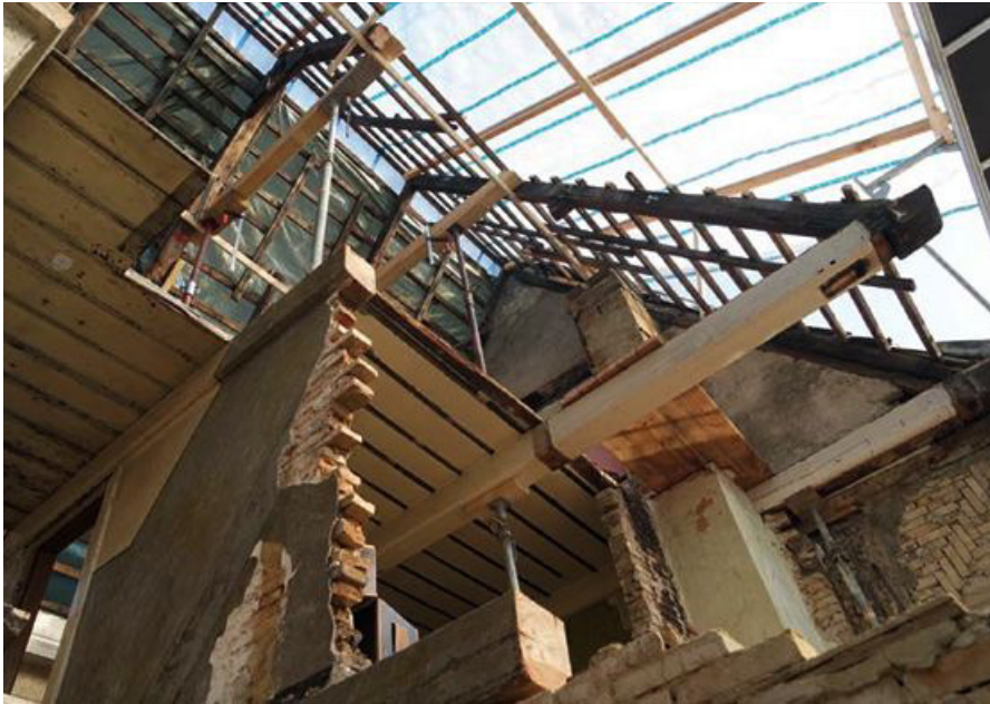
Zwischenzeitlich war nicht viel vom alten Sündenhaus übrig.
