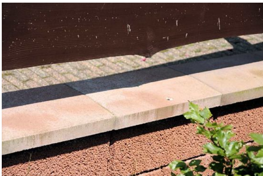
Verfärbungen: Die ursprüngliche Farbe der Abdeckplatten war nur noch an wenigen Stellen auf der Unterseite zu sehen
