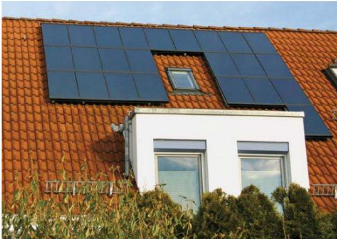
Mit Solarstrom aus einer eigenen Photovoltaik-Anlage wird die Wärmepumpe noch nachhaltiger.
