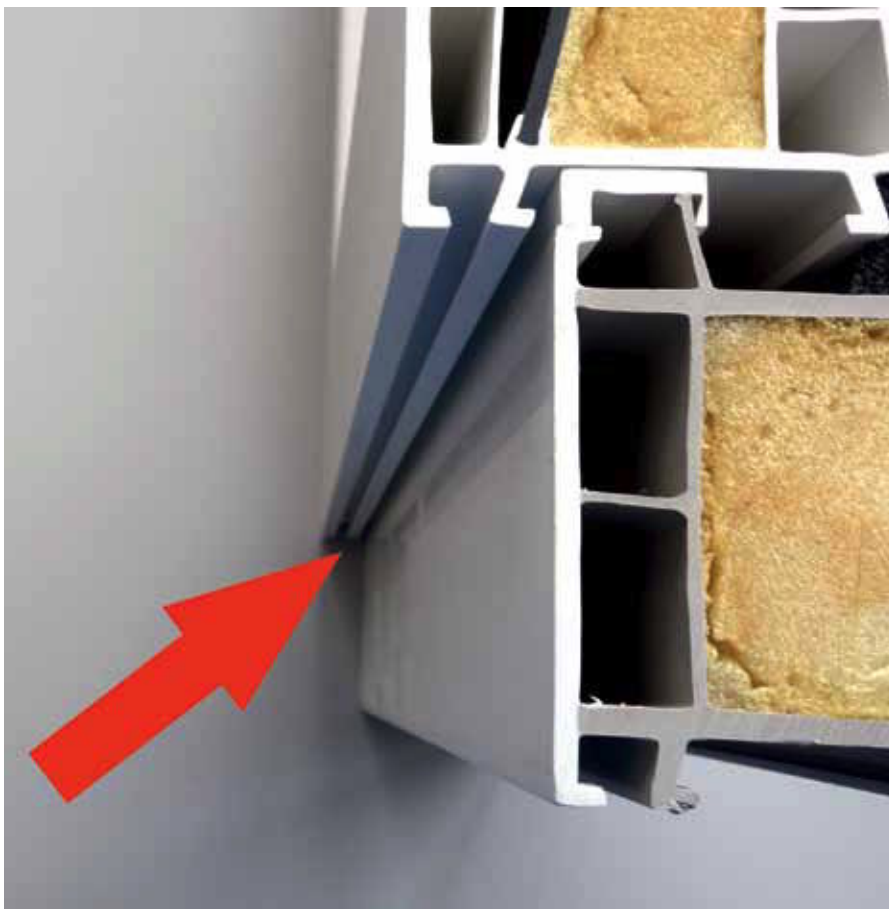
Bei Wind wird das Regenwasser in die Fensternut gedrückt und fließt ungehindert in Richtung Gewerkeloch.
