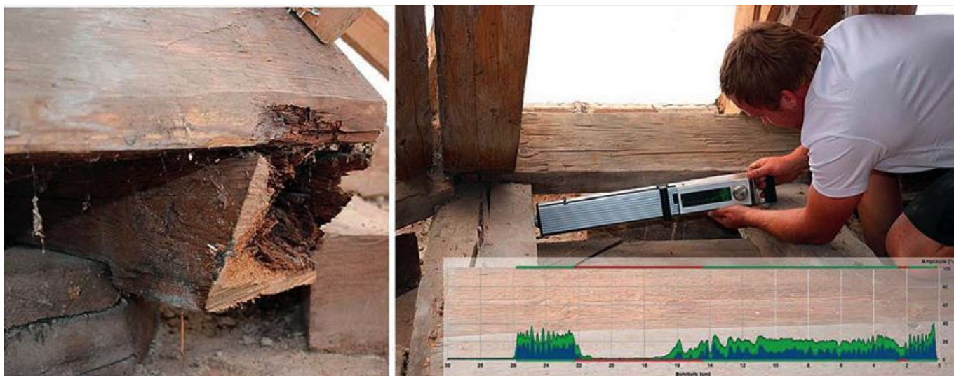
Bild 4: Der Balkenkopf weist im eingemauerten Bereich Schäden auf (linkes Bild). In 5-cm-Schritten vom geschädigten Kopfende kann mit Bohrwiderstandsmessungen der Übergang von geschädigtem zu intaktem Holz bestimmt werden. Im Bohrprofil ist der Schaden (rote Markierung) eindeutig zu erkennen.
