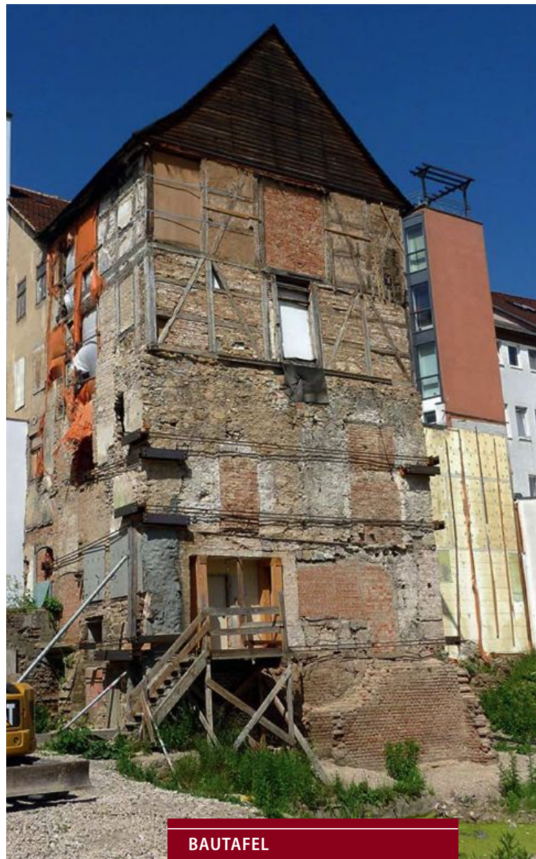
Bild 2: Auf der Hofseite war der marode Zustand des Gebäudes mit seinen hölzernen Fachwerkkonstruktionen gut zu erkennen.
