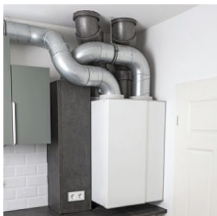
Eine zentrale Lüftungsanlage gewährleistet der Baufamilie eine gute Raumluftqualität.
