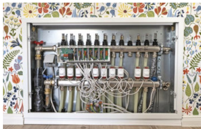
Die Fußbodenheizung, hier die einzelnen Heizkreise, verteilt die Wärme. Vorteil: Das System benötigt nur geringe Vorlauftemperaturen.
