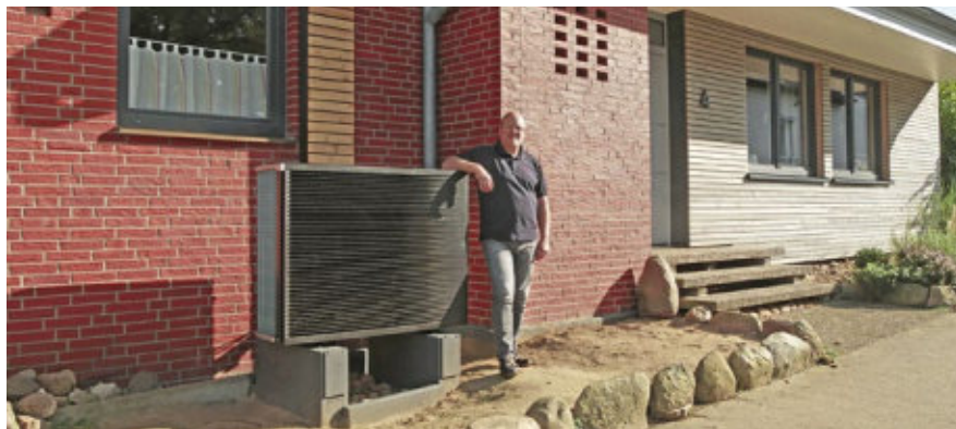
13 Die neue Wärmepumpe macht das Eigenheim von Volker Weinmann für die nächsten Jahrzehnte zukunftsfähig. Wird für den Betrieb komplett Ökostrom verwendet, ist das Heizsystem CO 2 -frei.
