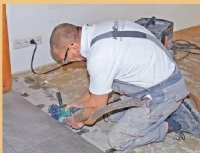
15. Nach einer gewissen Teilfläche wurde der Estrich entlang der Fliesenkante aufgefress, ...
