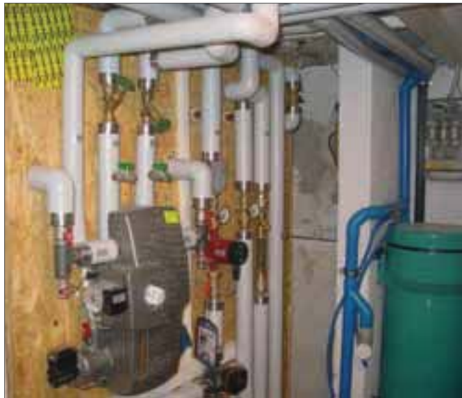
Hinter der Installationswand im Keller mit dem Frischwassermodul (silbergrau) befindet sich der Pufferspeicher, in mehreren Teilen eingebracht und vor Ort geschweißt. Rechts: Zentralstaubsauganlage (grün)
