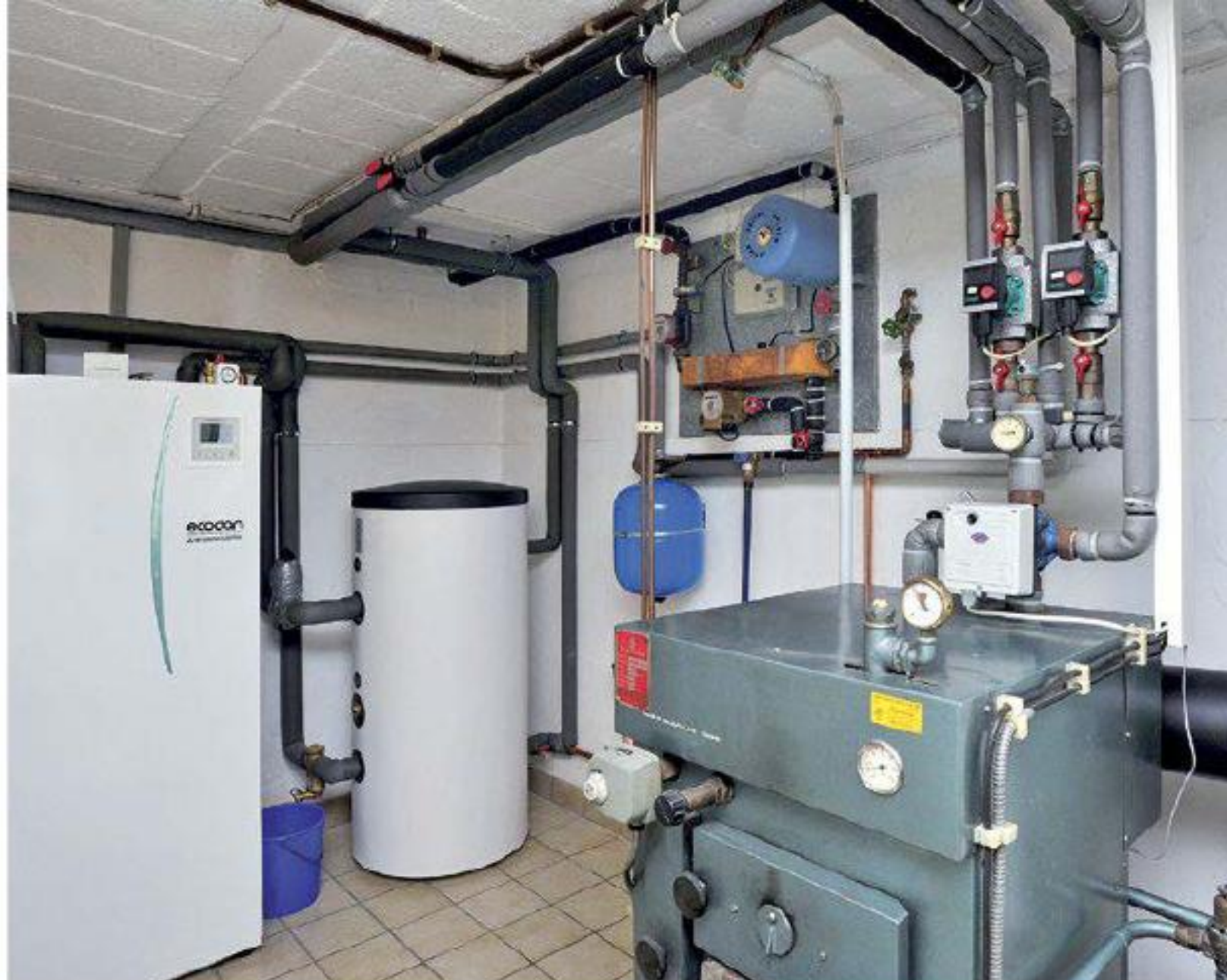
Die neue Split-Luft/Wasser-Wärmepumpe beheizt den Altbau bis zu einer bestimmten Außentemperatur; erst dann springt der alte Kessel ein, welcher nach der geplanten energetischen Gebäudesanierung stillgelegt wird. Mitsubishi Electric
