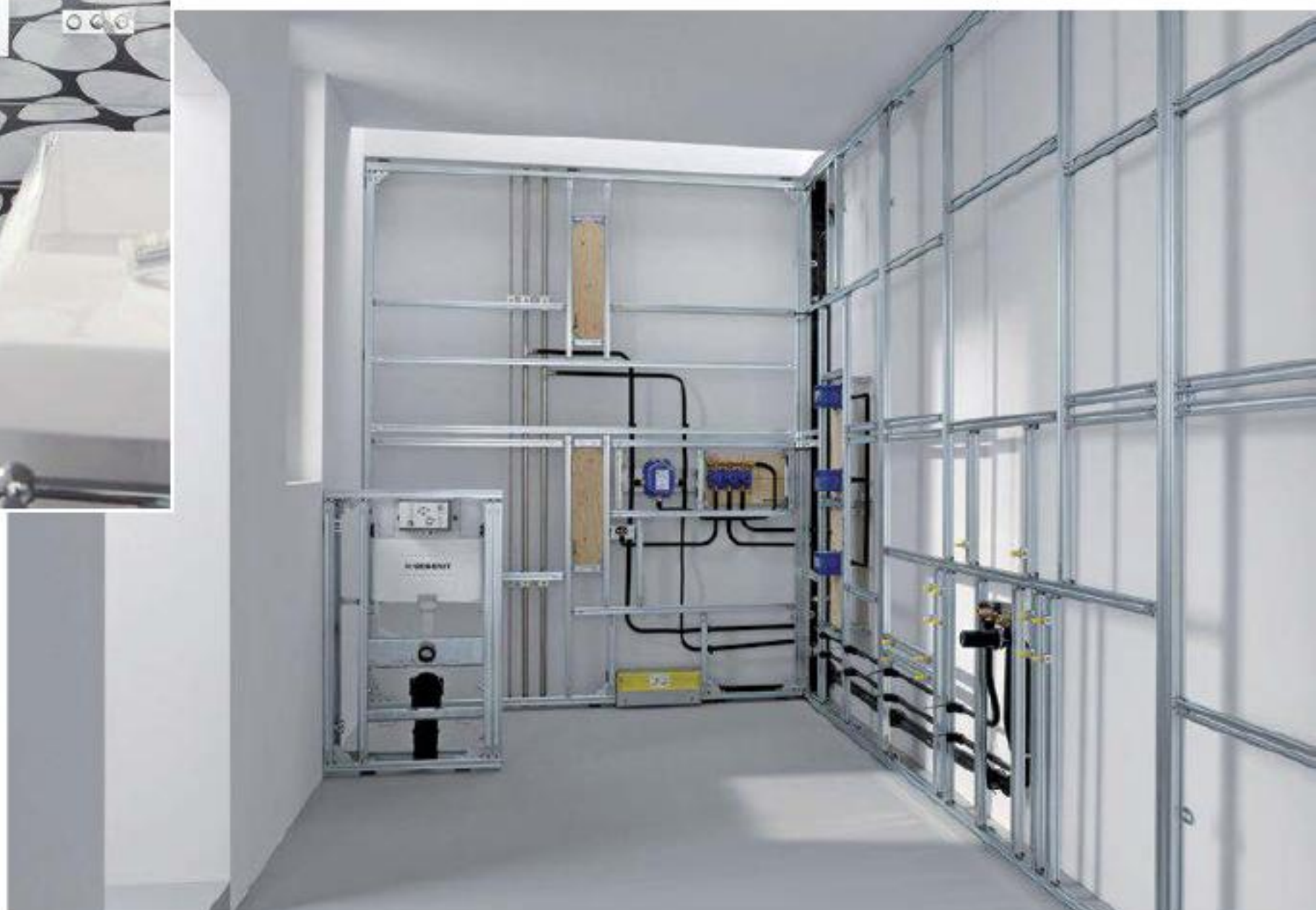
Walk-in-Dusche mit eingebautem Sitz (Foto links oben): Der Wandablauf von Geberit ist in die Vorwand integriert, so kann der Fußboden unterbrechungsfrei gestaltet werden. Die barrierefreie Dusche wird mit Sitzbank für den Nutzer noch bequemer. Geberit
