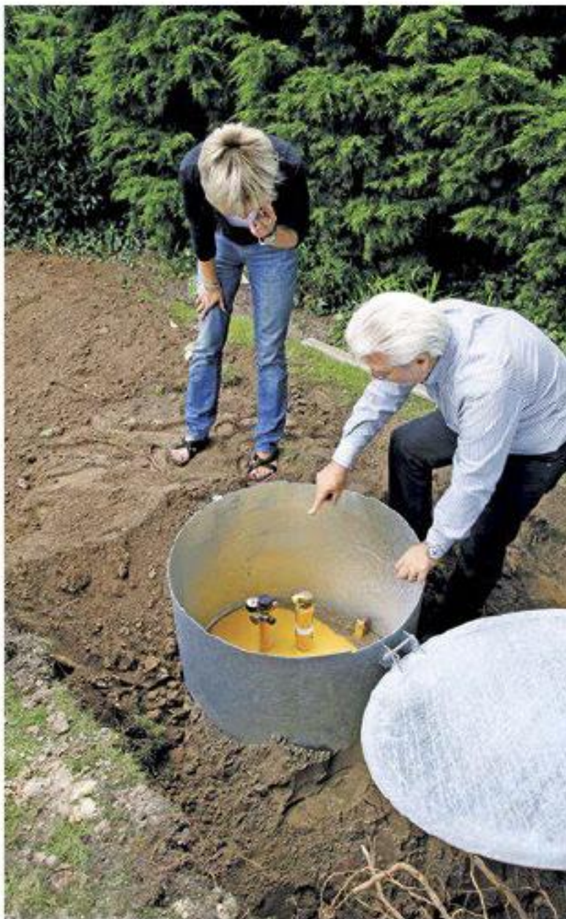
Im sogenannten Domschachts eines unterirdischen Tanks befinden sich alle für den Betrieb notwendigen Armaturen. Sie bleiben so von außen immer gut zugänglich. Primagas
