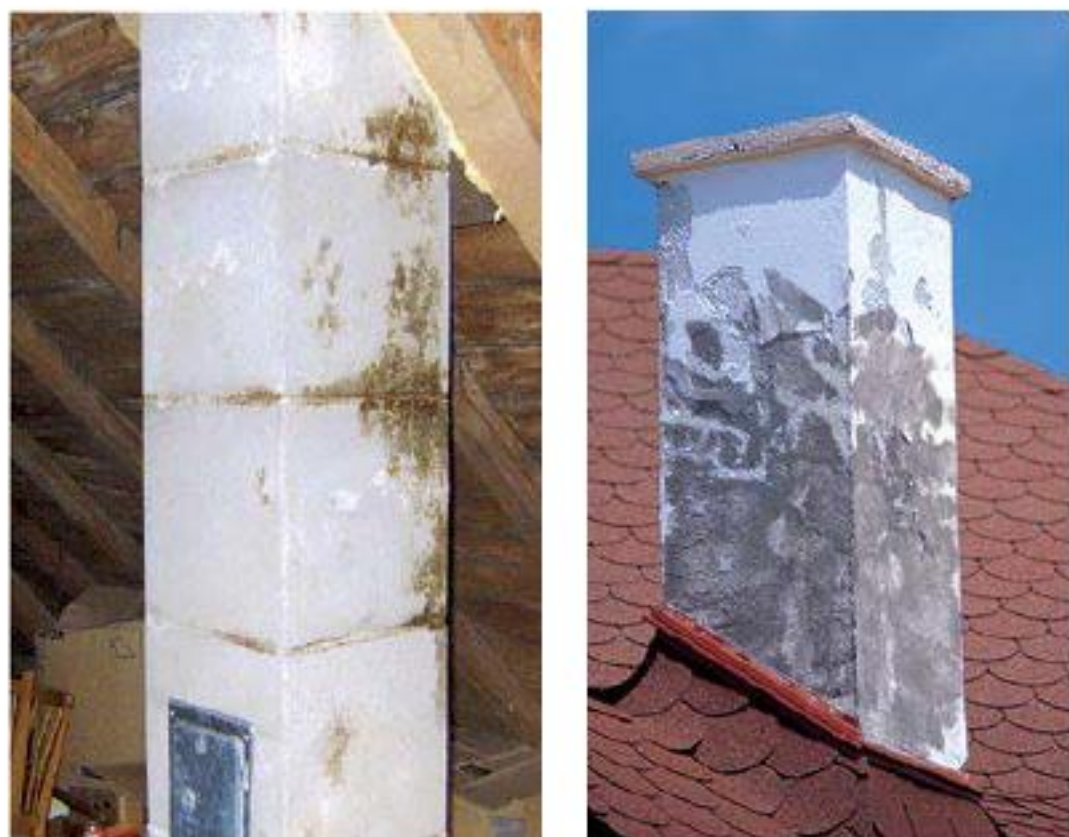
Schadensfälle durch Feuchtigkeit aufgrund falscher Betriebsweise („Versottung“) zeigen sich an sich ausbreitenden braun-gelben Flecken an den Außenflächen des Schornsteins oder am bröckelnden Putz des Schornsteinkopfes. Schiedel
