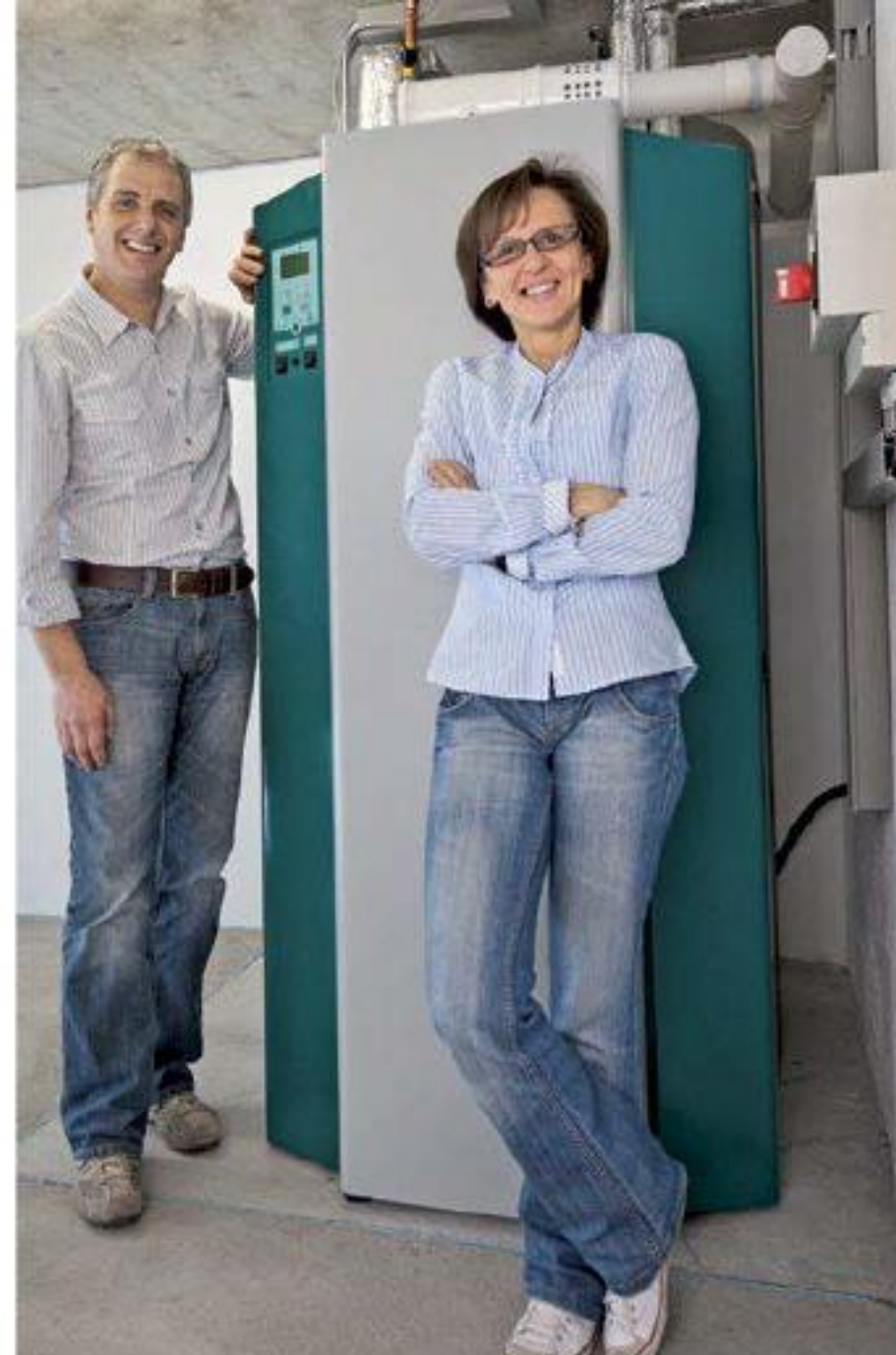
Kellerkraftwerk: Das Mikro-KWK „Dachs Stirling SE“ erzeugt parallel 1 Kilowatt (kW) Strom und 5,8 Kilowatt Heizwärme. Zum System gehören Pufferspeicher und 18-kW-Zusatzbrenner. Senertec
