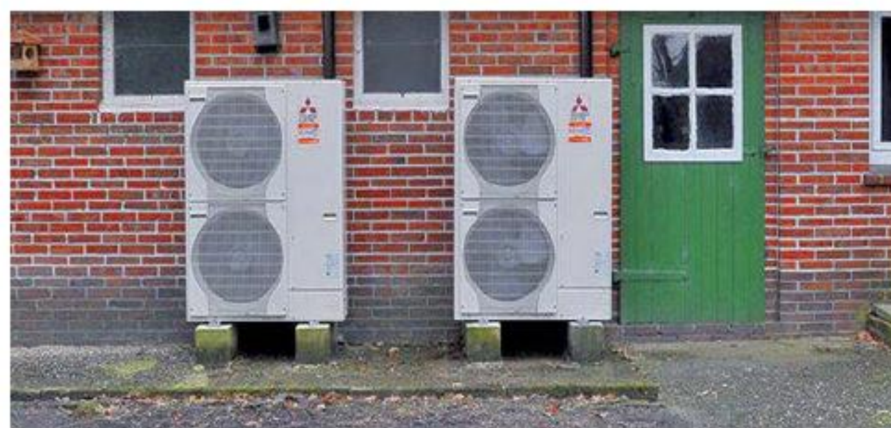
Die beiden Außenmodule stehen vor dem Anbau. Die Geräte sind in Kaskade geschaltet, sodass sie im äußerst effizienten Teillastbetrieb laufen können. Wärmepumpen gelten als umweltfreundlich, weil sie die Wärme der Umgebungsluft als Heizquelle nutzen.
