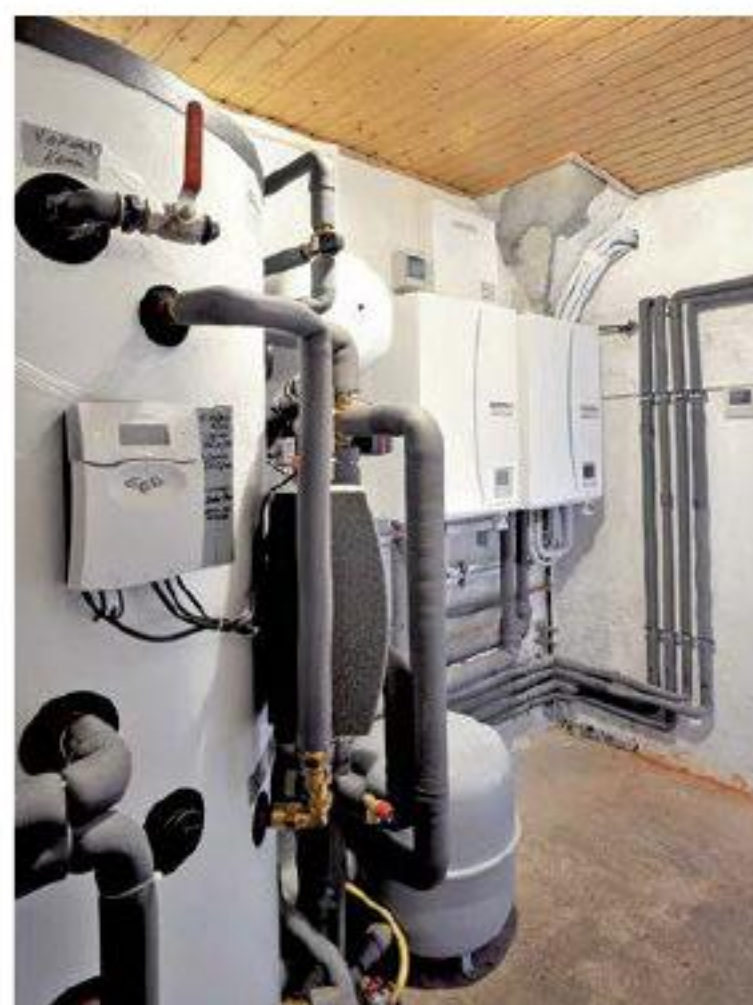
Die kompakten Hydromodule (im Foto hinten rechts) wurden im Hauswirtschaftsraum installiert, ein zusätzlicher Pufferspeicher optimiert die Kompressorlaufzeiten.
