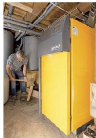
Ein Heizkessel, der mit Pellets und auch mit Scheitholz betrieben werden kann, beheizt das Schwarzwaldhaus.
