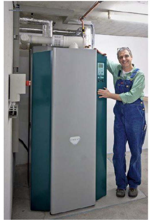
Kellerkraftwerk: Das Mikro-KWK „Dachs Stirling SE“ erzeugt parallel 1 kW Strom und 5,8 kW Heizwärme. Zum System gehören Pufferspeicher und ein 18-kW-Zusatzbrenner. Senertec
