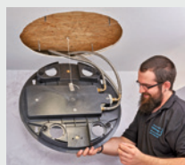
Jede der drei Leitungen wird später über eine der drei Tasten an der Duscharmatur für den Zufluss aktiviert.
