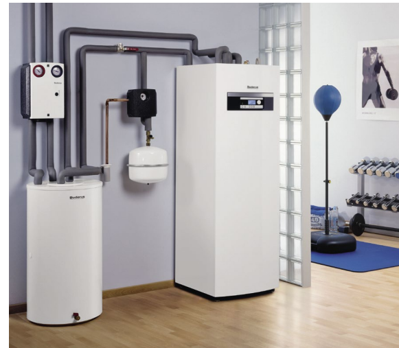
Erd-Wärmepumpe mit integriertem Warmwasserspeicher, verbunden mit dem Pufferspeicher: Aus dem Pufferspeicher wird das Heizsystem versorgt. Buderus
