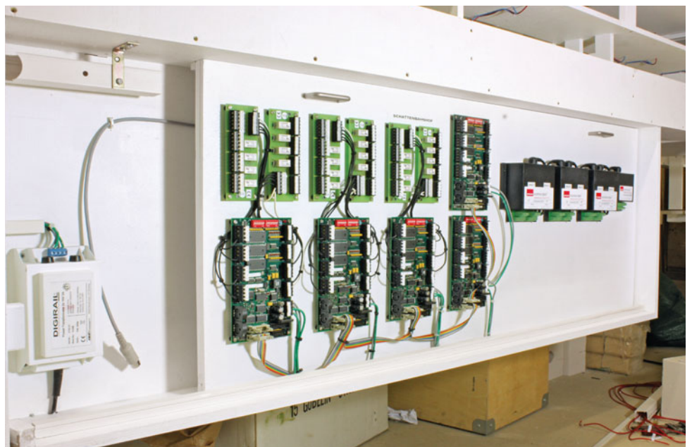
■ Unter der Anlage sind übersichtliche Schächte eingebaut, in denen die Steuerungselektronik untergebracht wurde.
