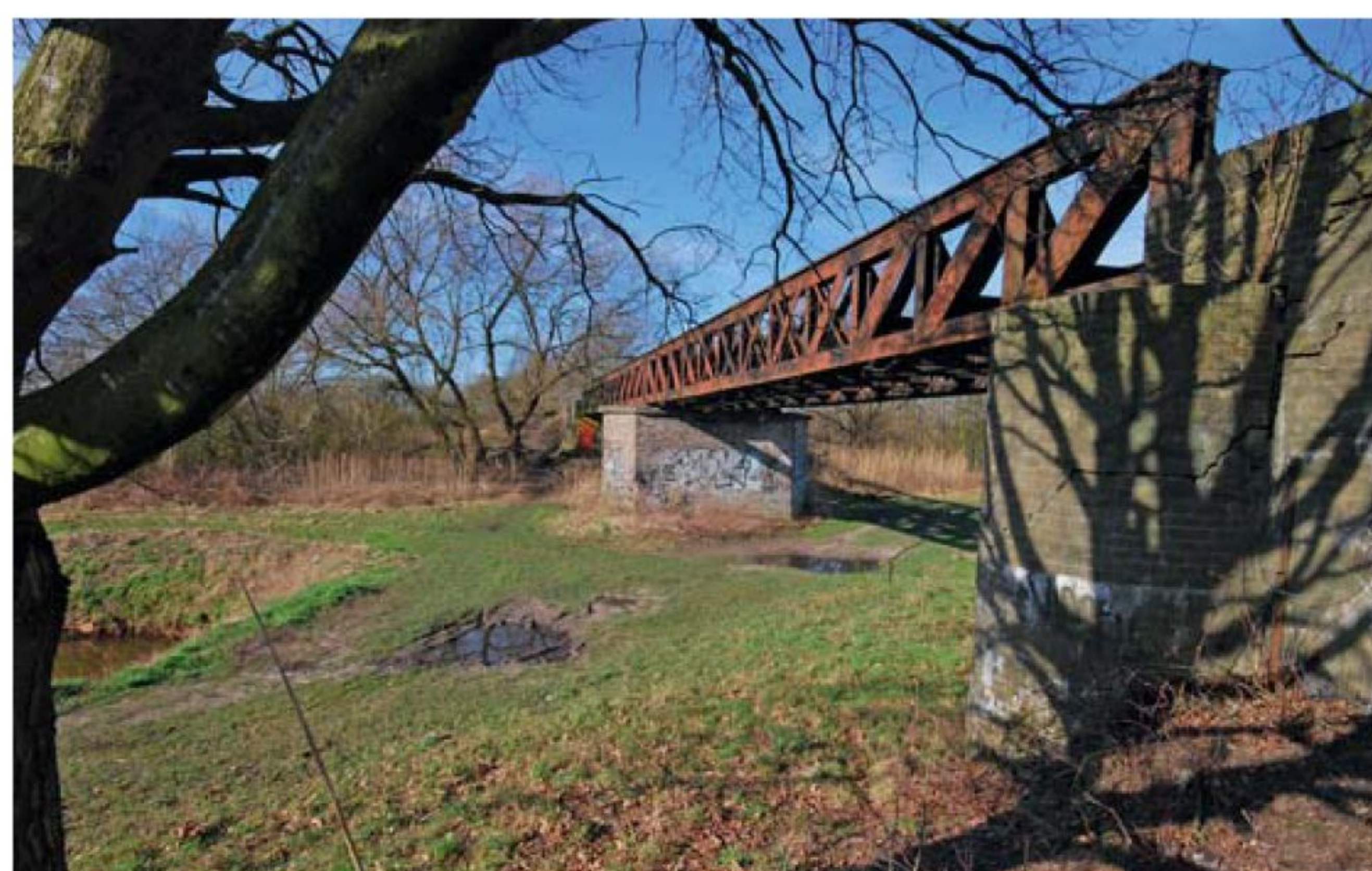
De Venkantbrug of Brug over de Bossche Sloot bij Vlijmen, voor de restauratie, 10 februari 2008.
