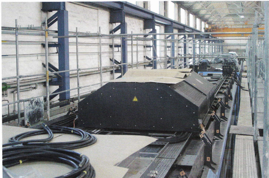
Bij de Protos zitten de powerpacks op het dak.
