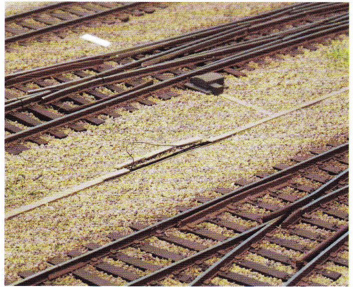
Bij seinen horen kabels. Vergeet niet de betonnen kabelgoten die langs de rails liggen.
