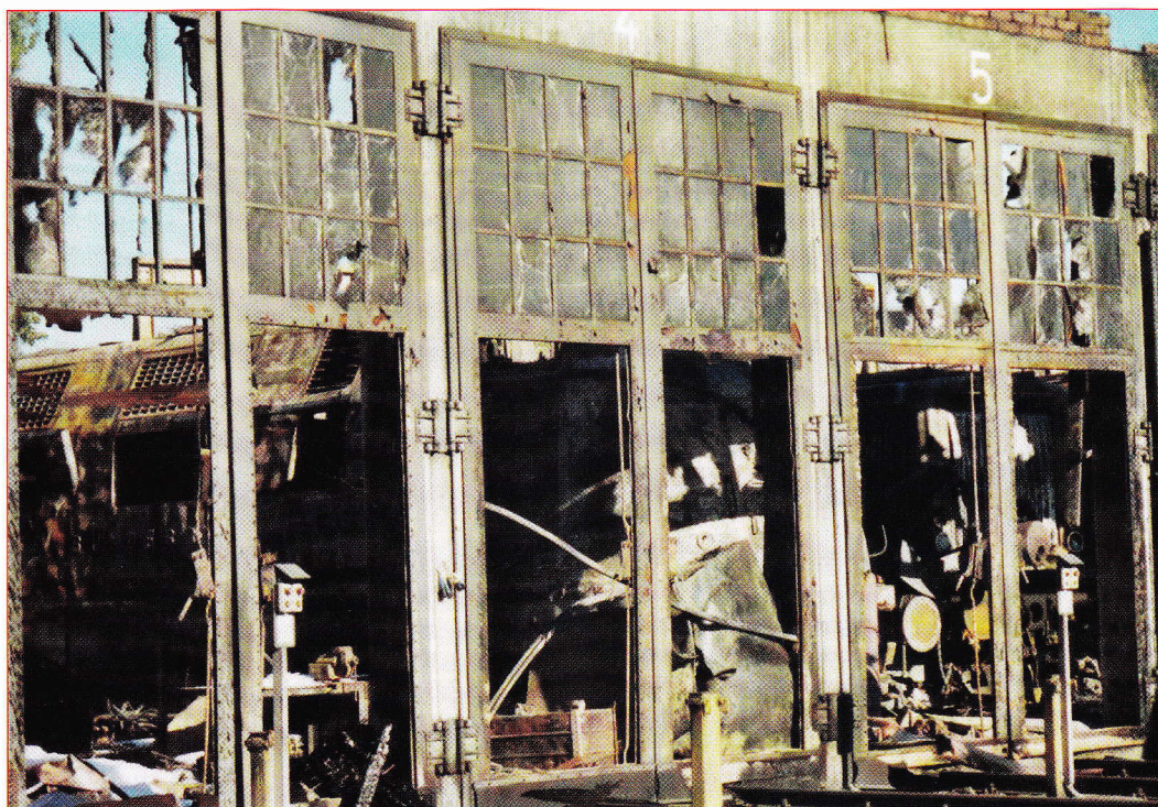
Achter de uitgebrande toegangsdeuren herbergt zich het wrak van de V200 002. De kans dat deze diesellocc wordt opgeknapt is te verwaarlozen. (foto Rolf Syrigos)
