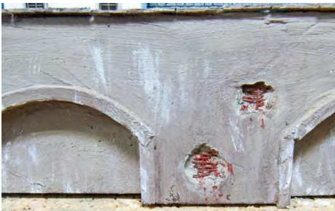
In den Aufbrüchen werden die Armierungseisen sichtbar
