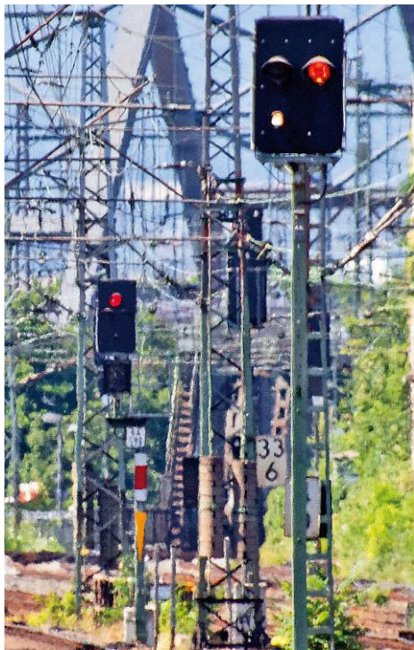
Signale in der Sommerhitze: Blick in Frankfurt-Niederrad zur Mainbrücke. Am Wiederholer vorne und dem dazugehörigen Mehrabschnittsignal im Hintergrund gibt es auf dem linken Bild die Signalfolge Ks 2 + Zusatzlicht zu Hp 0, auf dem rechten Ks 1 zu Ks 2
