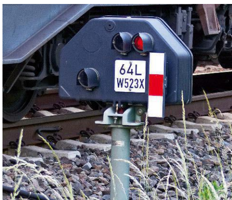
Neues Sperrsignal alter Bauform, jedoch mit nur noch einem roten Licht
