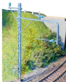
Streckenmast mit Rüsselausleger für den größeren Gegenabzug in der Kurve. Am Mast ist außerdem die Speiseleitung befestigt
