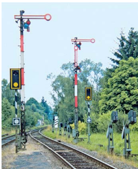
Blinklichtüberwachungssignale der neueren Bauform (nur mit unterer, gelber Scheibe) als Wiederholer – sichtbar an dem weißen Kreis unter dem gestreiften Mastblech.
