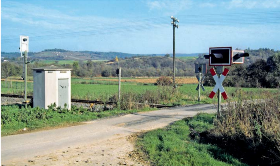
Hier wurde allein schon ein Feldwegübergang mit Blinklichtanlage (auch zur Seite hin) gesichert. Dies macht das im Laufe der Zeit gestiegene Sicherheitsbedürfnis deutlich.
