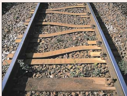
Y-Schwellen im Übergangsbereich
