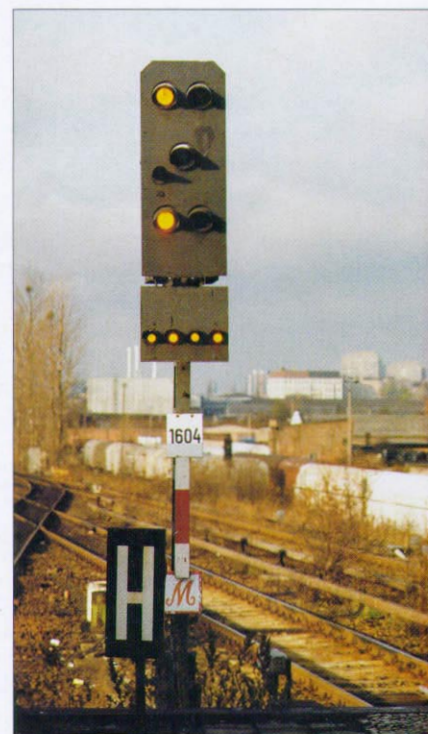
HI 9b im Berliner Bahnhof Ostkreuz. Die Bedeutung des Signals: Fahrt mit 60km/h, dann mit 40 km/h. Das obere gelbe Licht blinkt.
