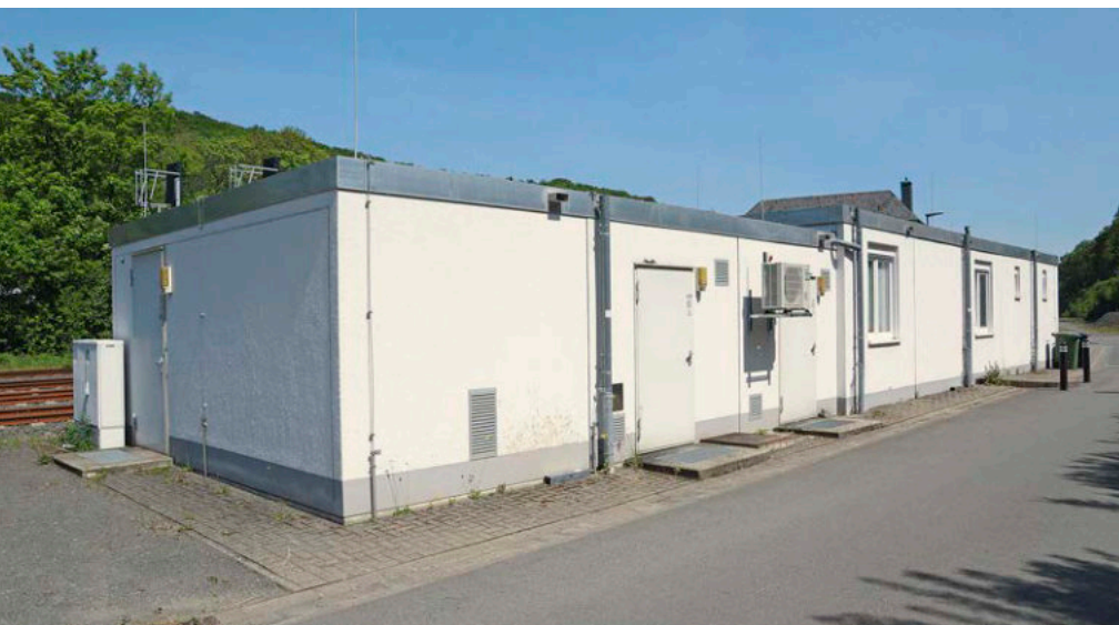
Das ESTW im Bahnhof Lüdenschied-Brügge ist in klimatisierten Containern untergebracht. Von hier aus wird der gesamte Eisenbahnverkehr der Volme-, Agger- und Listertalbahn gesteuert.
