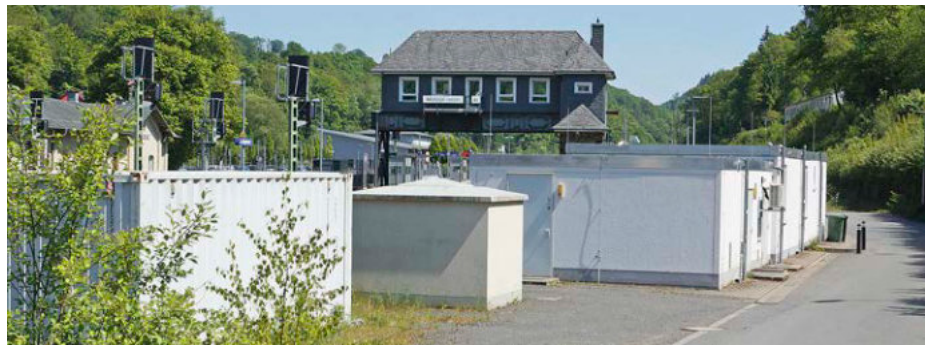
Das Personal der elektronischen Stellwerke muss keine Sicht mehr auf die Gleise haben, sodass mehrere Eisenbahnnetze, wie hier in Brügge, zusammengefasst werden können. Im Hintergrund das alte Eisenbahnbrückenstellwerk, das durch das ESTW in den Containern ersetzt wurde.
