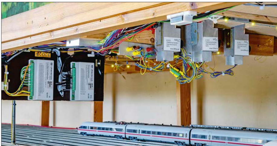
Die Unterseite der Wattenscheider Schächte ist im Schattenbahnhof sichtbar. Die Signale sind mit Mini-Bananensteckern angeschlossen.
