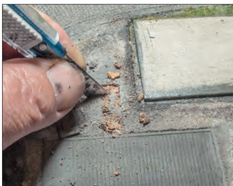
Der Kanal zum Wiegehäuschen wurde vergessen und musste nachträglich eingebaut werden.
