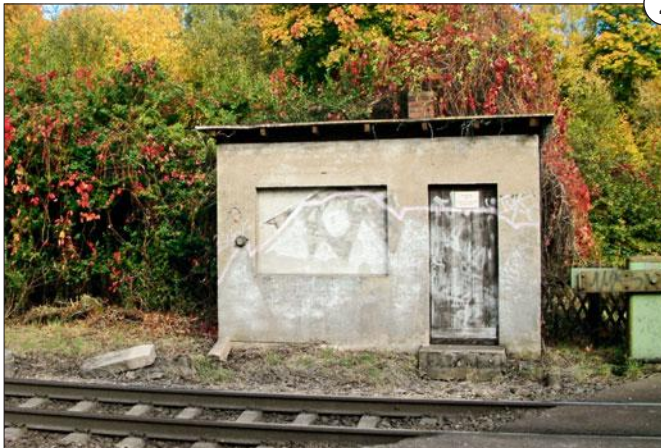
2008 sah das Gebäude schon sehr heruntergekommen aus.
