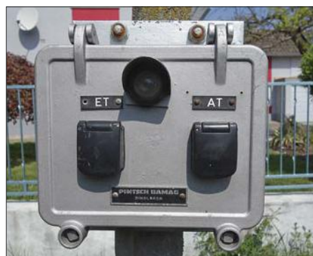
Oben: Schlüsselschalter für manuelles Ein- und Ausschalten bei defekten Schaltkontakten
