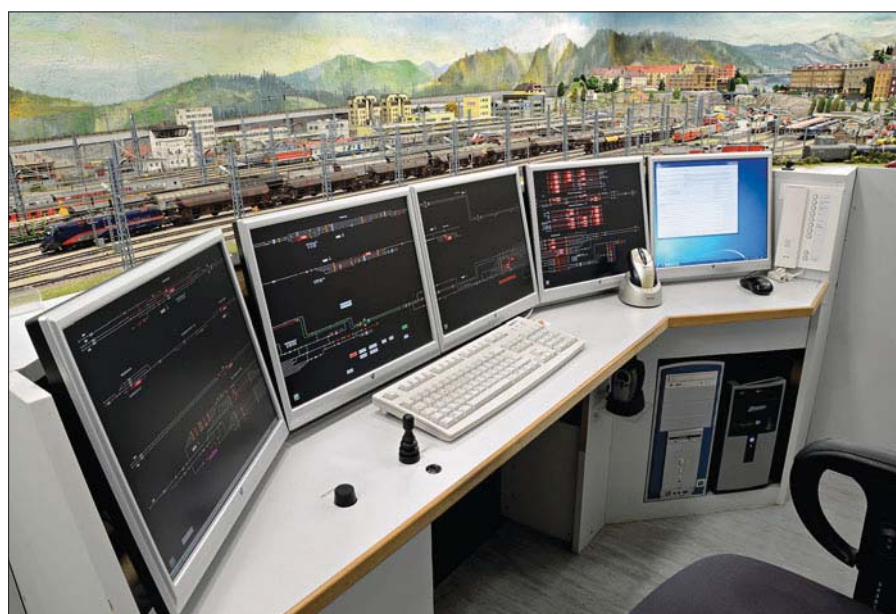
In unmittelbarer Umgebung von Steinbach Hbf befindet sich die Kommandozentrale mit Rechnern und fünf Bildschirmen. Hinter dem Stuhl sind in einer Mauernische 19-Zoll-Gestelle mit Einschüben für die vielen Steckkarten und Leitungsanschlüsse zur Anlage angeordnet.
