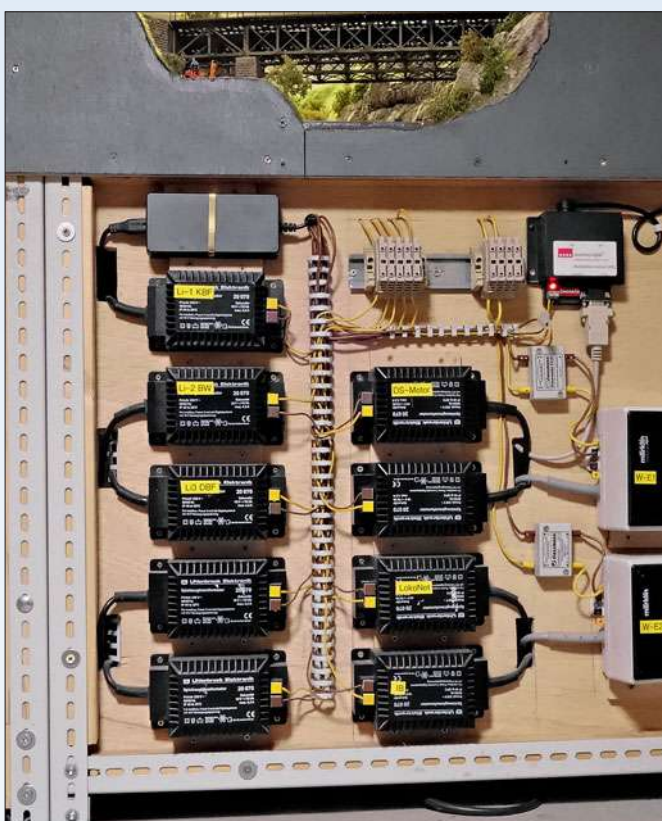
Auf einer weiteren Schalttafel dienen Transformatoren der Stromversorgung von stationären Decodern zum Schalten von Weichenantrieben, Servos und Licht. Auch hier besticht die Installation durch saubere Verarbeitung. Das minimiert schon bei der Verkabelung die Fehlerquellen.
