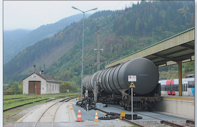
In Unzmark (Österreich) befindet sich diese Umladeanlage für Mineralölprodukte mit Auffangwanne zum Schutz der Umwelt. Fotos: sk
