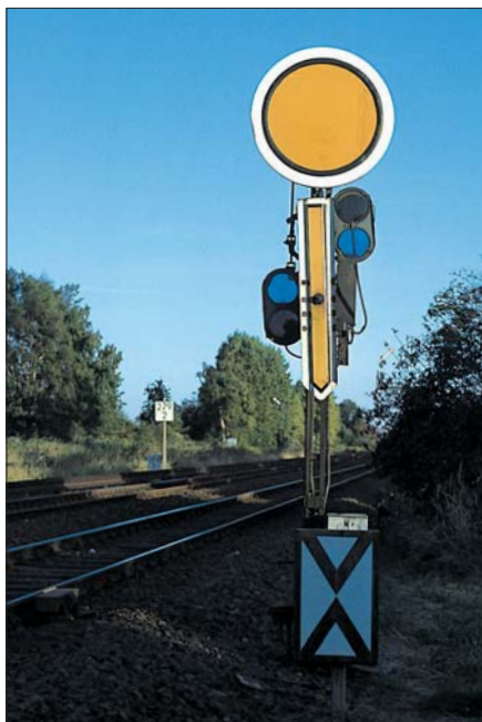
Das Einfahrsvorsignal des Gbf Billwerder im Oktober 1983. Das Signal besitzt einen Mast der Ursprungsbauforn und hat nachträglich den Zusatzflügel sowie die Blendensteuerung eines Signals der Bauart Vo 44 erhalten.
