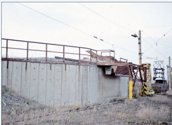
Eine Schüttrampe, mit der die Wagen mittels Lkw beladen werden können, befindet sich am Rand der Bahnanlage. Die Beladung erfolgt mit klappbaren Blechen über den Wagen. Die erhöhte Ladestraße wird durch eine Betonwand gesichert.
