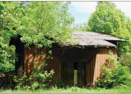
Der Güterschuppen in Alling hat auch schon bessere Zeiten erlebt. Fotos: Ingrid Peter
