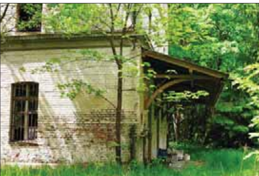
Die Gleisseite des dem Verfall preisgegebenen Empfangsgebäudes von Alling. Die Bilder stammen vom Mai 2012.
