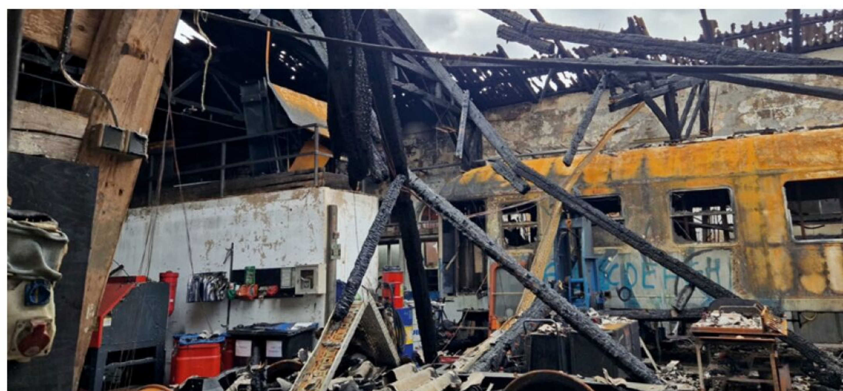
Nach dem Brand bot sich in dem Lokschuppen ein katastrophales Bild.
