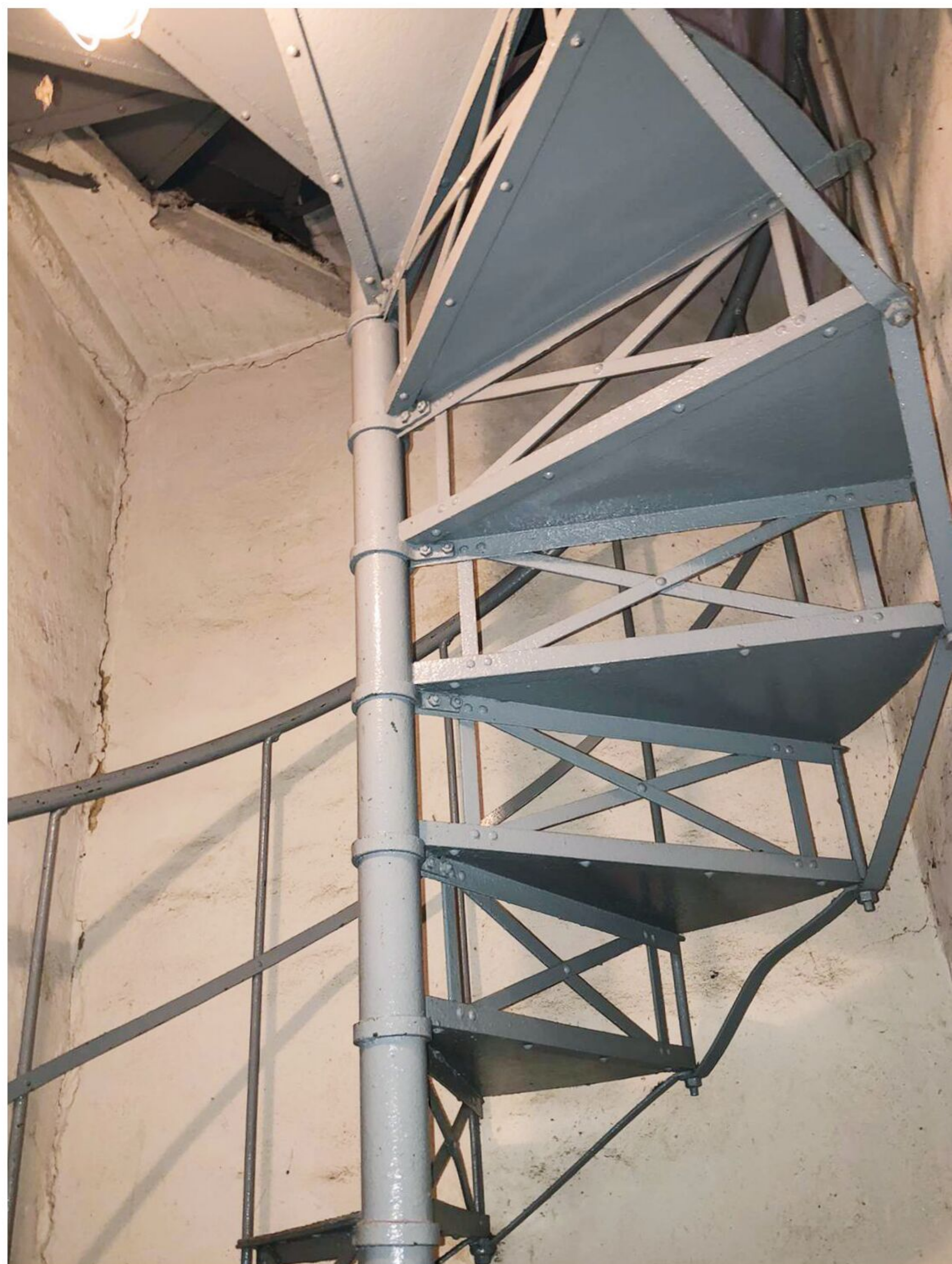
Engstelle: Die steile Wendeltreppe im Turm ist für größere Anlagenteile zu schmal. Die kommen dann durchs Fenster.
