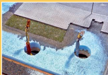
Variante 3: Durch ein Loch, geschnitten mit einem Lochschneider, steckt man eine am Draht befestigte Lampenfassung mit Birne.
