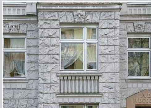
Der historische Bau wurde als typische Bausünde nicht zeitentsprechend, sondern mit neuen, großflächigen Kunststofffenstern versehen.
