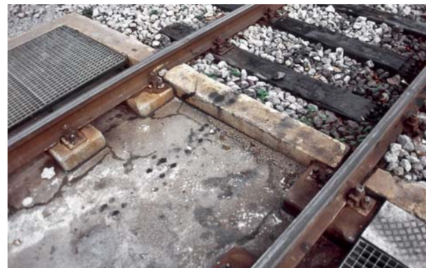
Im Bereich der Ölauffangwanne ruhen die Kleisen auf kleinen Betonsöckeln.
